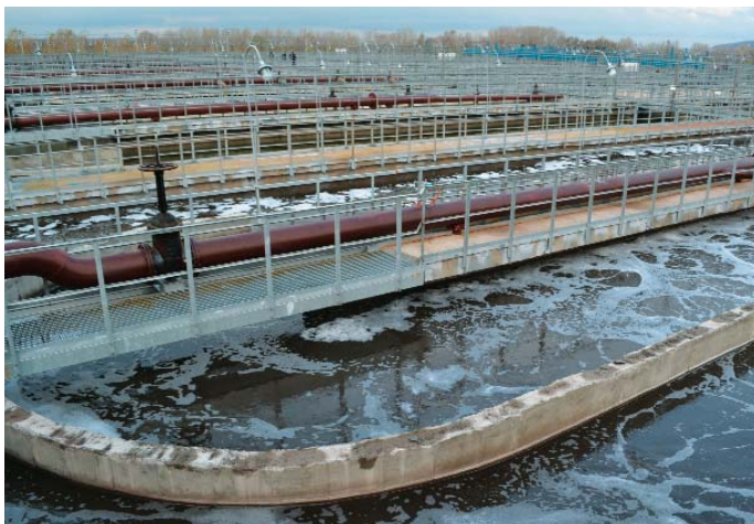
Блок биологической очистки сточных вод
