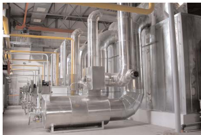
Отделение низкотемпературной сушки осадка с ленточными сушильными установками «KLEIN»
